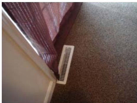
床にエアコンの吹き出し口
