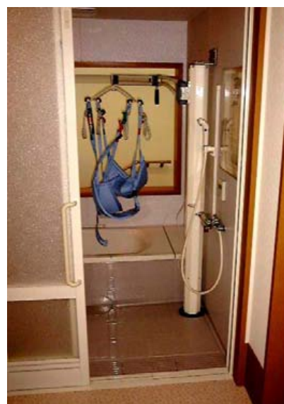
図9 介助者の労力を軽減するためのリフトを設置した浴室
